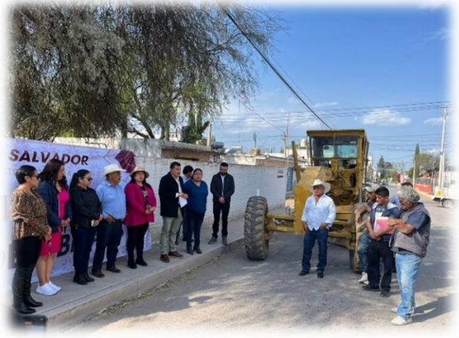
8 de enero 2025. Arranque de obra pavimentación asfáltica calle Insurgentes (Santa María – Colorado), Santa María Amajac.
